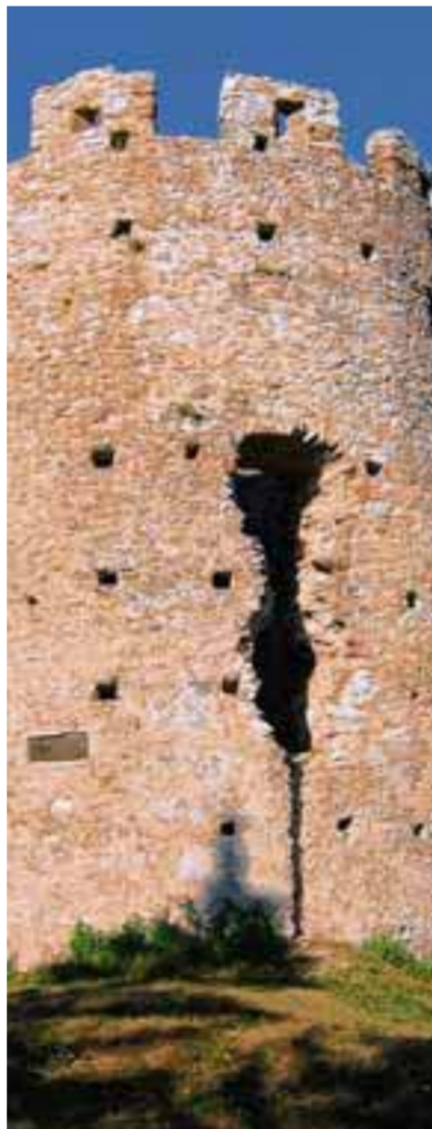
Das Artillerierondell der Vorburg mit seinem markanten Mauerausbruch wurde bei der Konservierung mit viel Fingerspitzengefühl gesichert.
